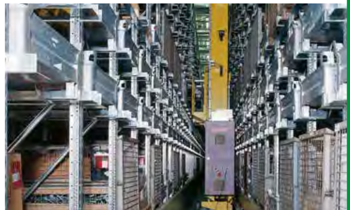
Automatisiertes Palettenregal im Einplatzstellsystem
