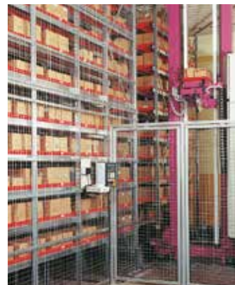
Grillage protecteur et cloisonnement
